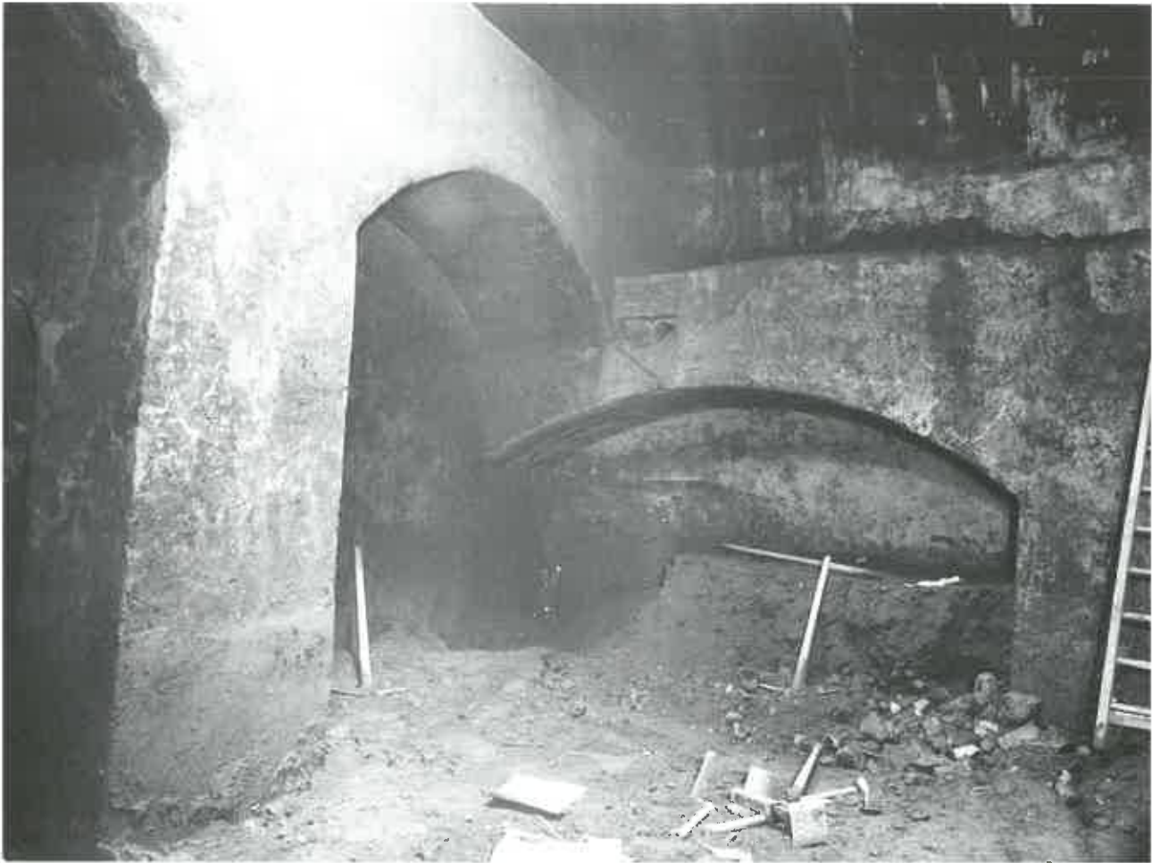
Fig. 2 - Fotografia della cisterna sotto piazza Santa Maria (Fototeca Biblioteca Comunale di Blera).
