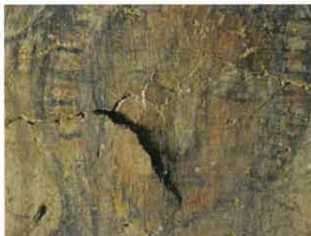
Fig. 4 - Distacco dell'intonaco dal supporto murario.
